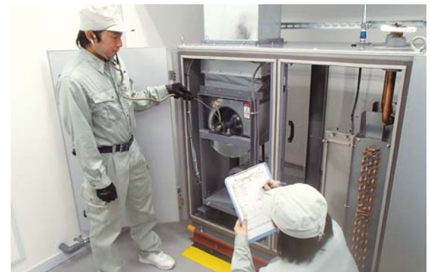
外調機点検研修
